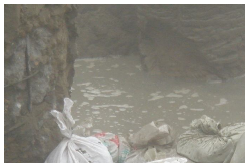
图 2 坑底突涌现场
